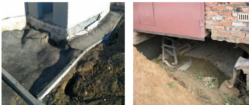
Рис. 1. Случаи просадки грунта
